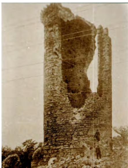
Fig. 6- la Torre di Pagliapoli dopo i due sismi del 1907 e 1908.
